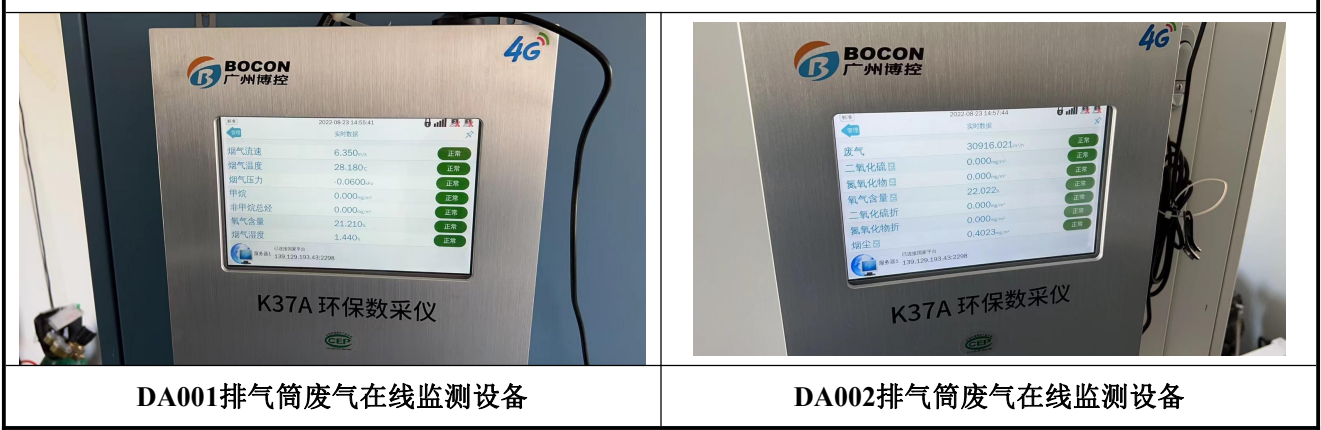
图4-8 在线监测设备现场照片
