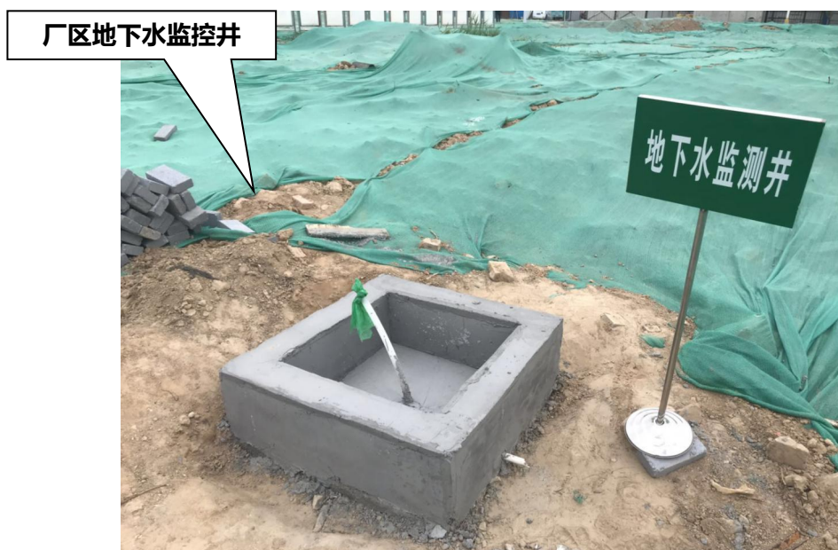
图 4.2-6 厂区地下水监控井设置情况
