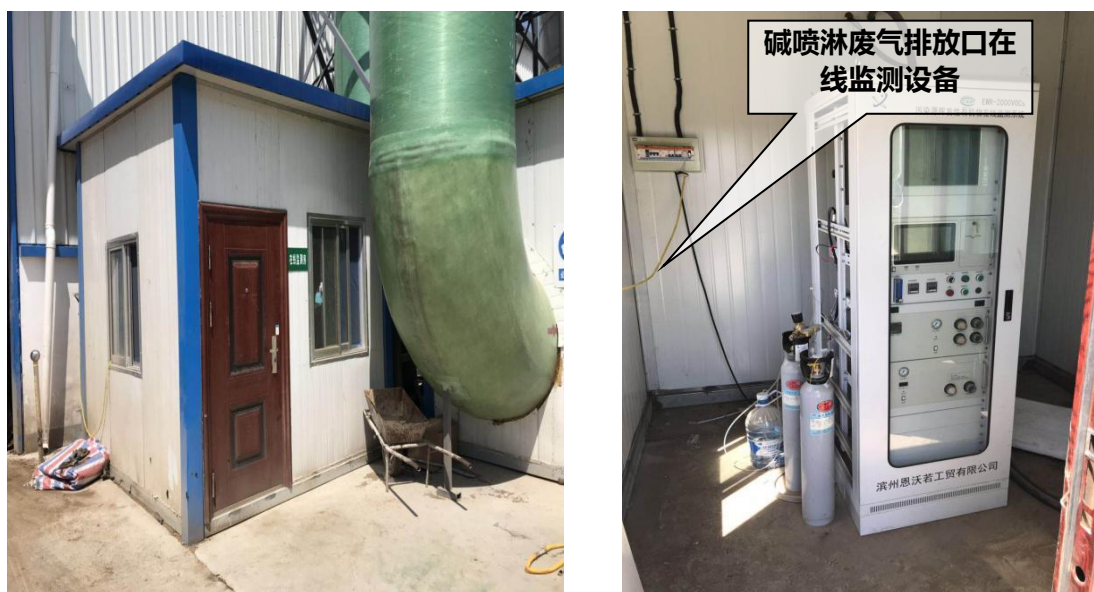
图 4.2-14 碱喷淋废气排放口在线监测仪安装情况
