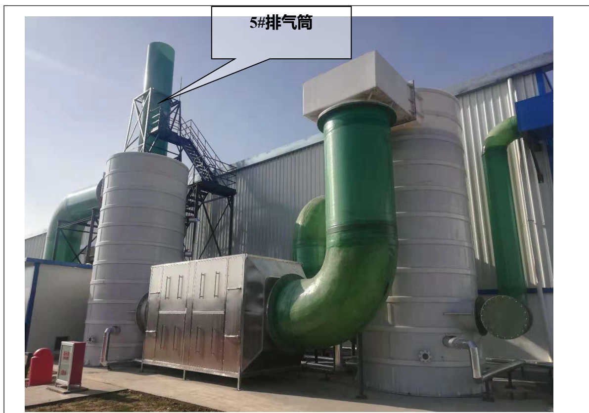
图 4.1-3 (2) 污水处理车间“二级碱吸收+光催化降解”装置及排气筒实际建设情况 项目有组织废气产生治理排放情况见表 4.1-1。
