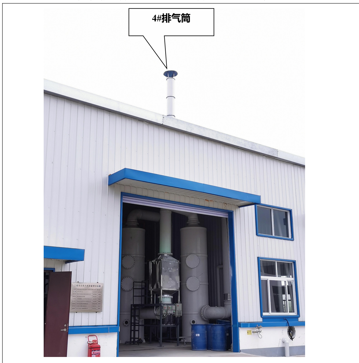
图 4.1-3（1） 减量化车间“二级碱吸收+光催化降解”装置及排气筒实际建设情况
