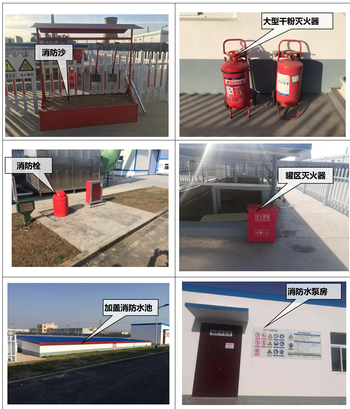
图 4.2-1 消防设施设置情况
