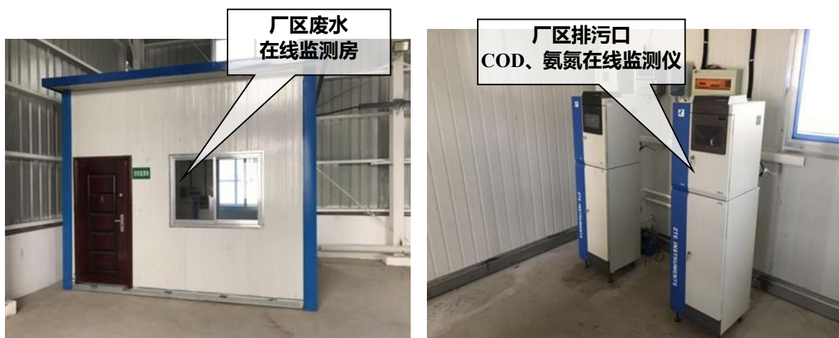
图 4.2-13 废水排放口在线监测仪安装情况
