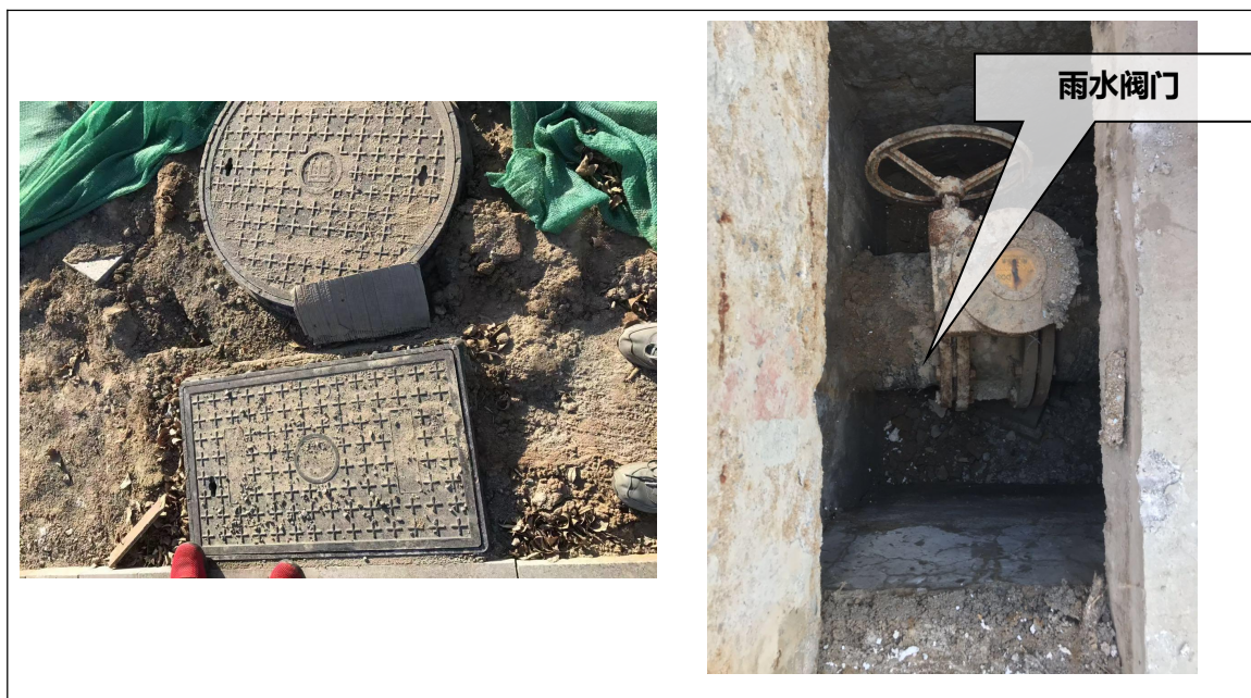
图 4.2-4 厂区雨水排口阀门设置情况
