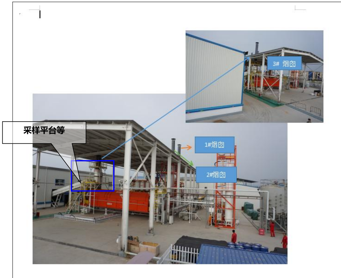
图 4.1-1 热相分离单元废气治理设施及排气筒实际建设情况
