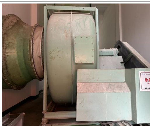
原料仓库除臭风机
