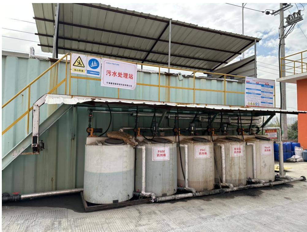
图 4.1-4 项目污水处理站现场照片
