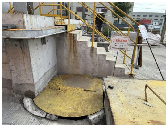
初期雨水收集池照片
