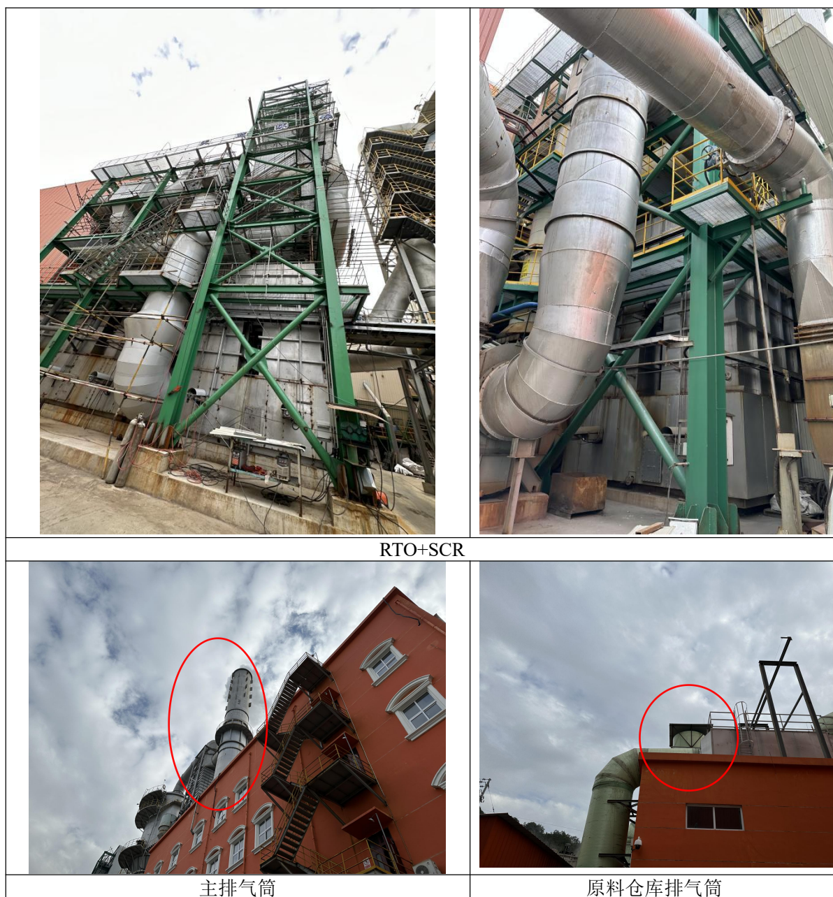
图 4.1-2 废气处理设施现场照片
