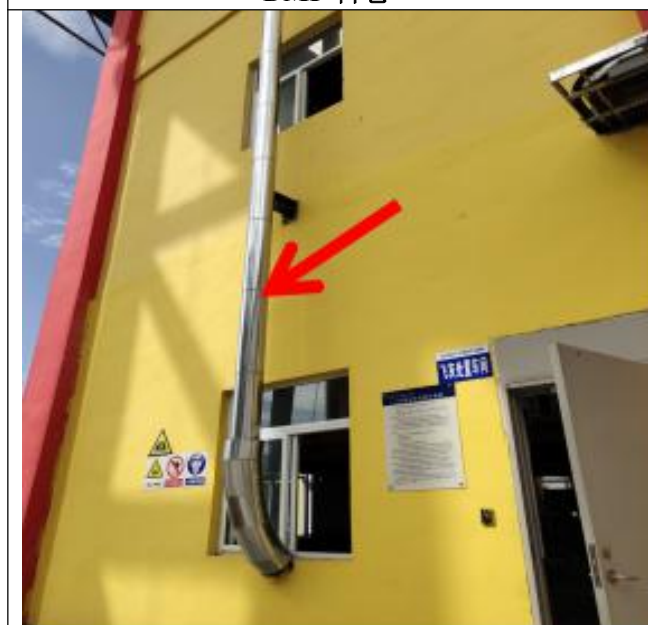
飞灰输送管道
