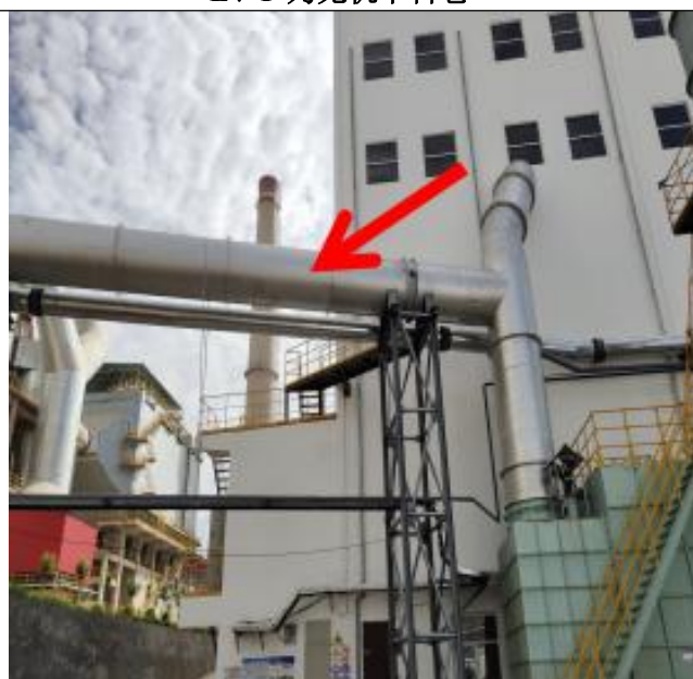
预处理中心废气输送管道
