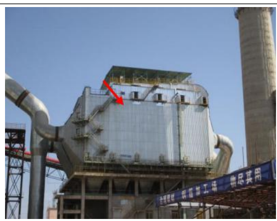
窑尾高效布袋除尘器
