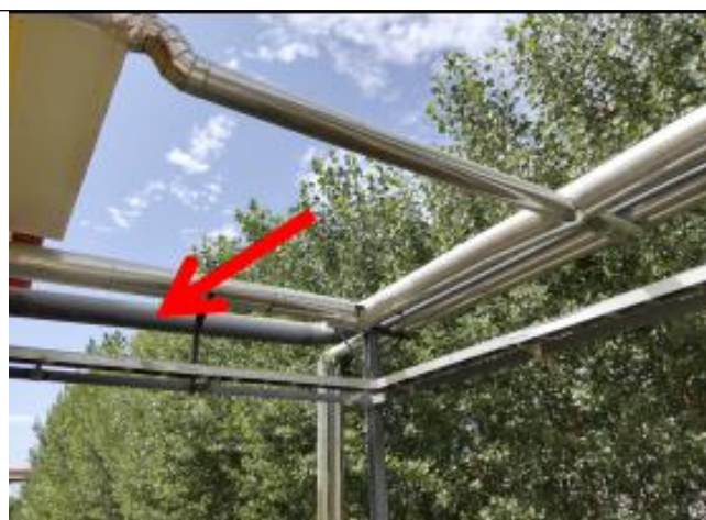
废液输送管道
