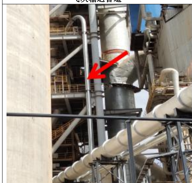
DMP 输送管道
