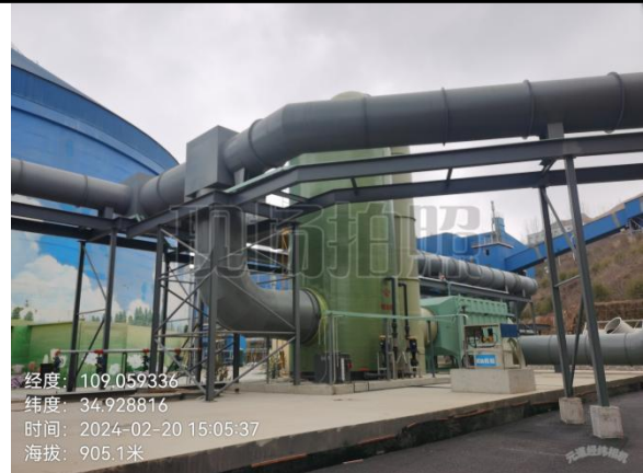
固废暂存废气收集管道
